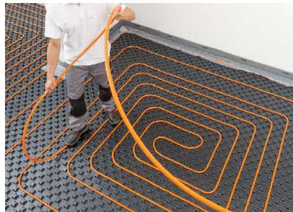
Suelo radiante hidráulico
